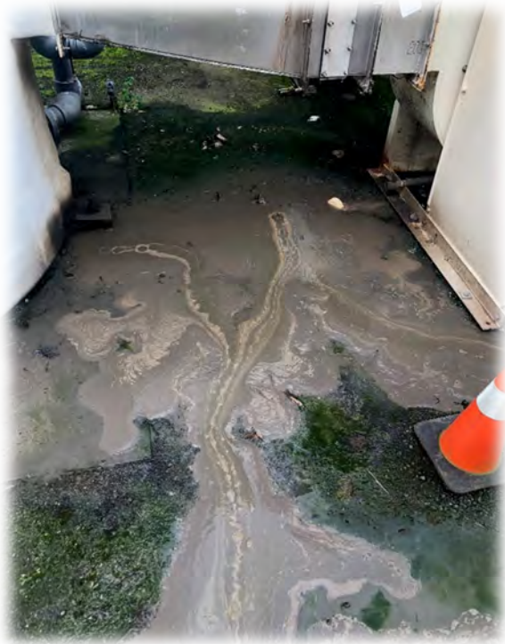
5) Odor Control Tower Gunk
