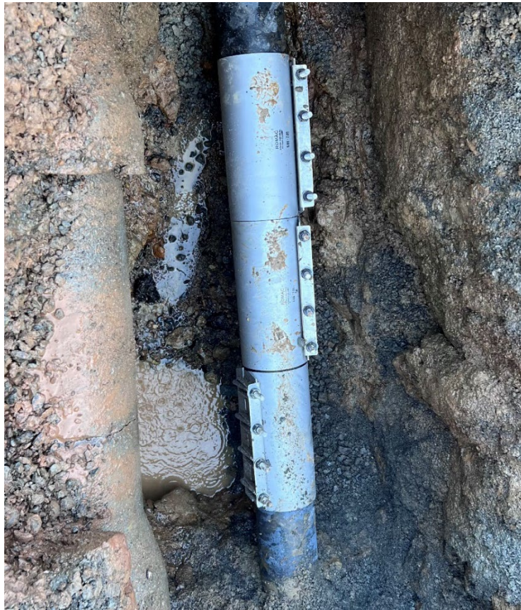
SE Colina Vista Ave Main Break
