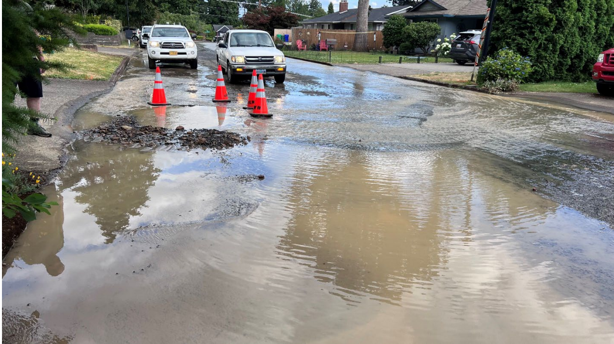
SE Colina Vista Ave Main Break
